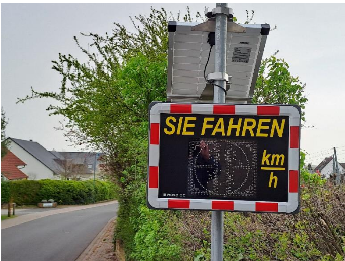
Tempomessgerät wurde ehrenamtlich von Jens Nicklis installiert
